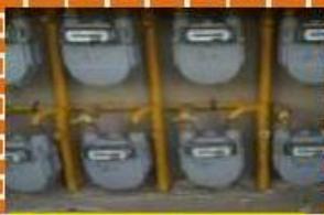
Fugas de gas
