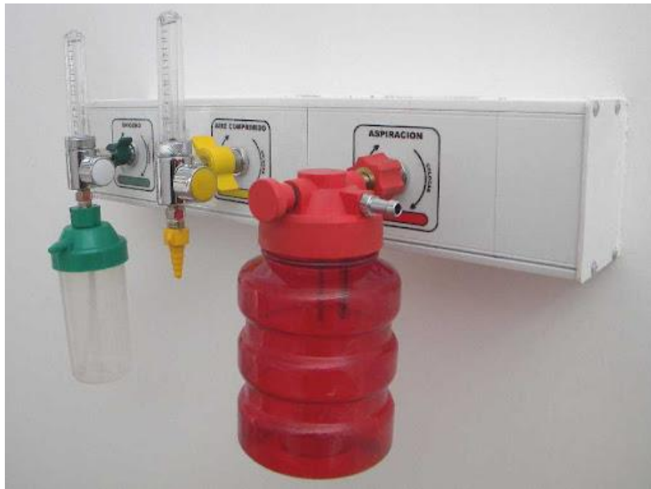
SISTEMA CENTRAL DE GASES MEDICINALES (OXIGENO VERDE; AIRE COMPRIMIDO AMARRILO Y ROJO SISTEMA DE ASPIRACION CENTRAL)
